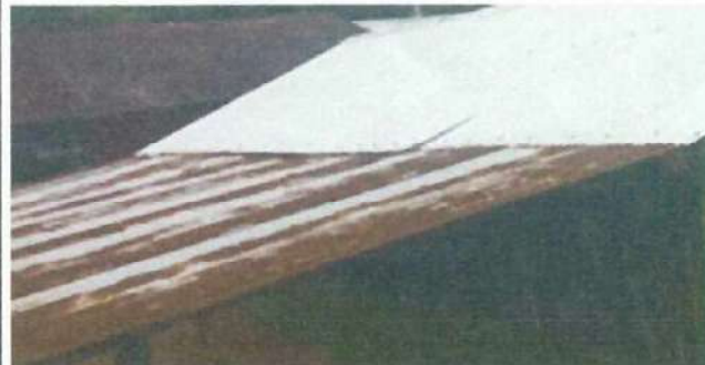
Foto 2: Se ha identificado desgaste y deterioro en la cubierta de láminas del centro educativo, lo que afecta su funcionalidad y pone en riesgo la protección de la infraestructura.
