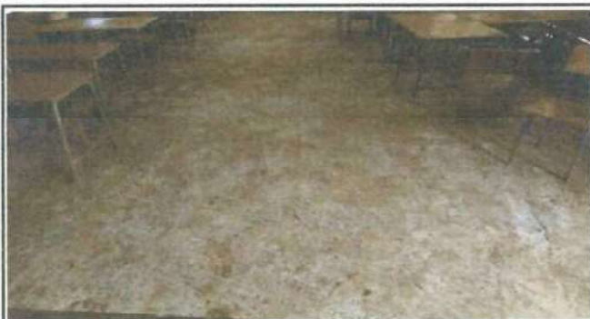
Foto 3: Se ha identificado el deterioro de la torta de concreto, evidenciando desgaste que pueden afectar la estabilidad y seguridad de la estructura.
