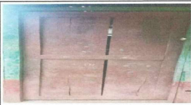
Foto 4: Se ha evidenciado que las puertas del centro educativo se encuentran en mal estado, presentando deterioro que afecta su funcionalidad, seguridad y durabilidad.
