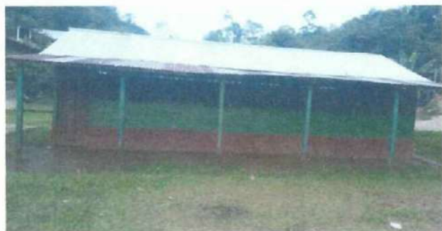
Foto 1: Se ha identificado el deterioro general de la infraestructura de la escuela, evidenciando daños en distintos elementos que afectan su funcionalidad y seguridad.
